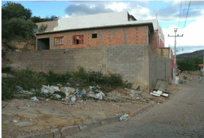
Figura42: Problemas na execução dos serviços
